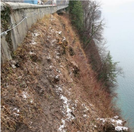
Rutschgebiet oberhalb SBB-Gleis
