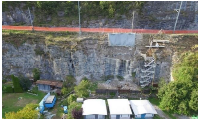
Unterhalb SBB-Gleis; Rutschgebiet
